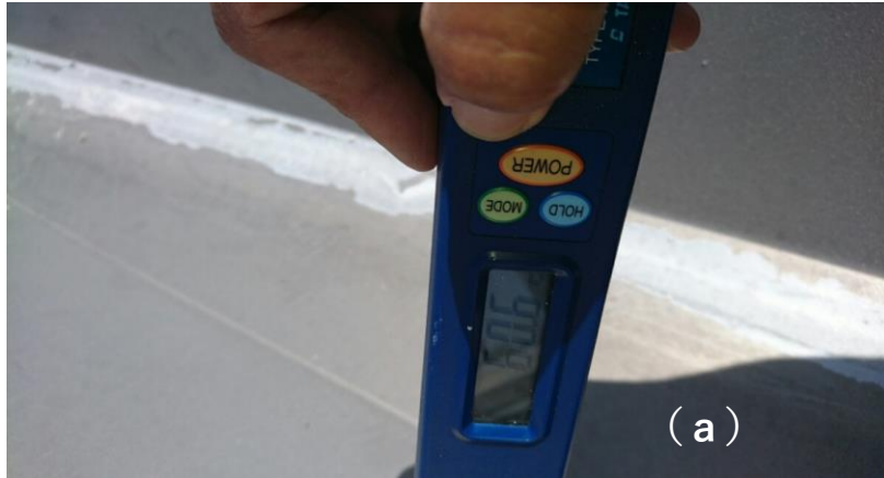
(a) 無塗装部分 折半屋根表面 60.6°C
